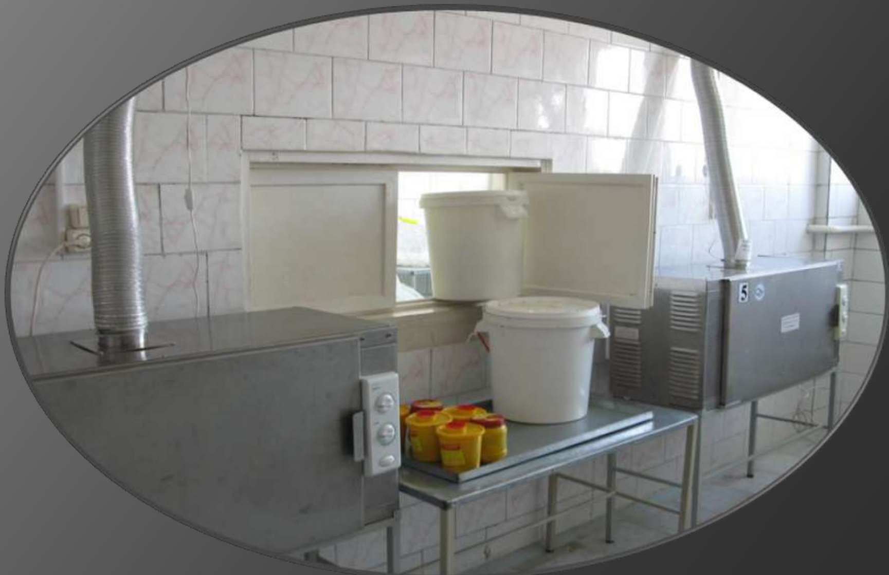
Помещение для обеззараживания отходов
